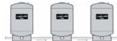
Instalación lineal de varios tanques.
